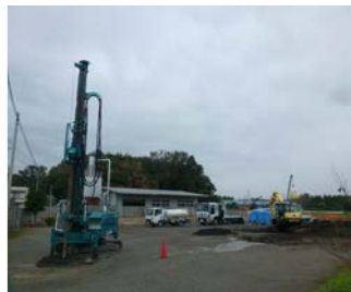
地中にコンクリートを 流し込む工事をしています。(H25年9月撮影)
